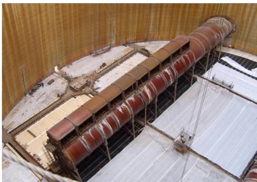
Рисунок 1.6 – Трубчатый газораспределитель для отвода уходящих газов, размещенный внутри башни градирни
