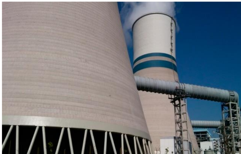
Рисунок 1.5 – Вид башенной градирни, совмещенной с системой отвода дымовых газов (показан подводящий газоход)
