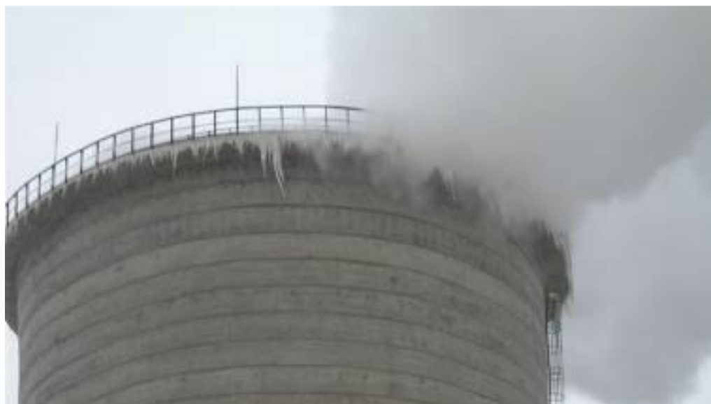
Рисунок 1.10 – Обмерзание верхнего опорного кольца вытяжной башни градирни [72]
