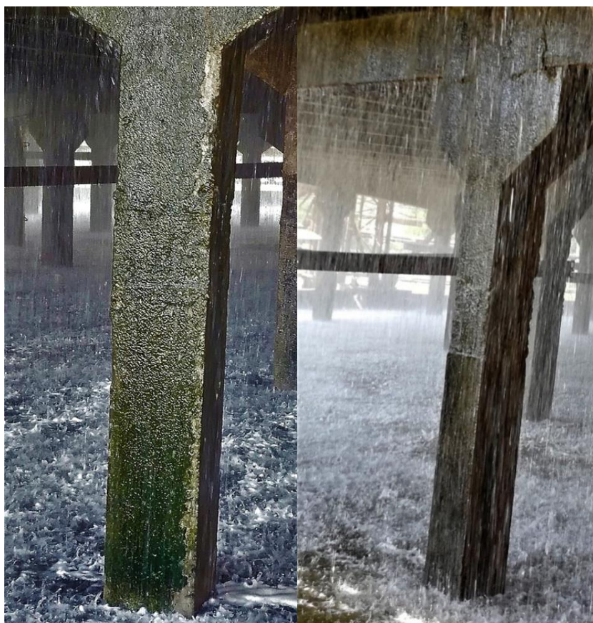
Рис. 4.10. Фотографии биологического обрастания на железобетонных стойках градирен
