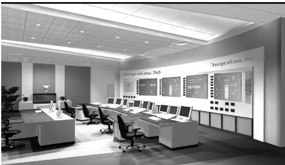
Рис. 5. БЦУ энергоблоков 800 МВт №№5,6 ОАО «Рязанская ГРЭС» с полномасштабной АСУ ТП на базе ПТК «Квинт»
