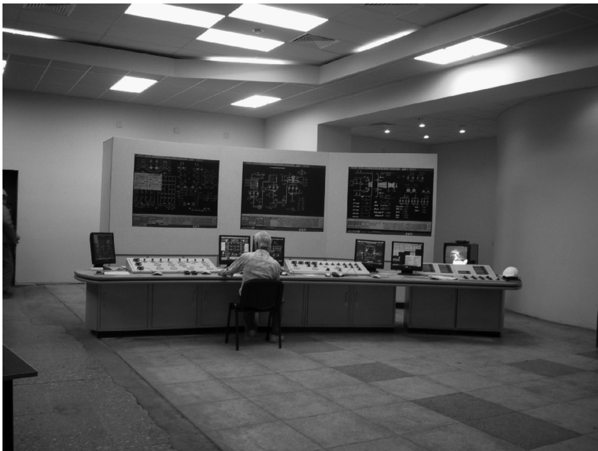
Рис. 4. Блочный щит управления энергоблока 300 МВт №6 ОАО «Костромская ГРЭС» с полномасштабной АСУ ТП на базе ПТК «Квинт»
